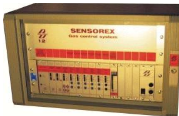
12 kanavainen AVA-UNIT 12 "Rittal" kaapissa
